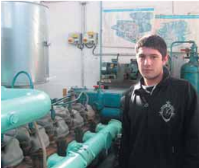
Jérôme, à la surveillance et à la maintenance des moteurs
