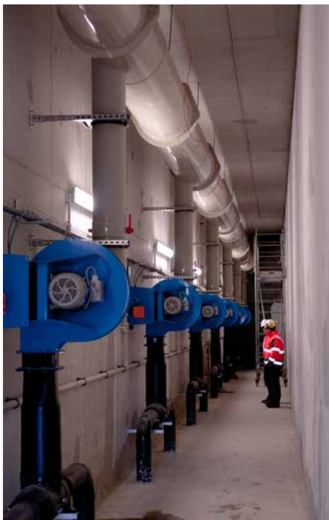
Photo de l'Usine de Lézinadou
